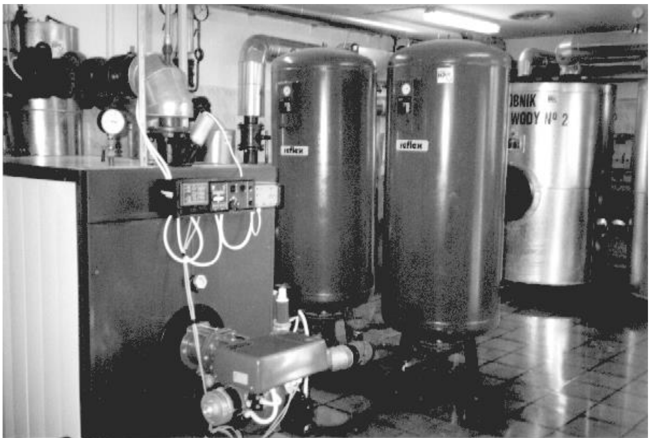
FOT.28. Kotłownie wodne gazowe o łącznej mocy 2500 MW. (J.W. – Balice - Kraków).
