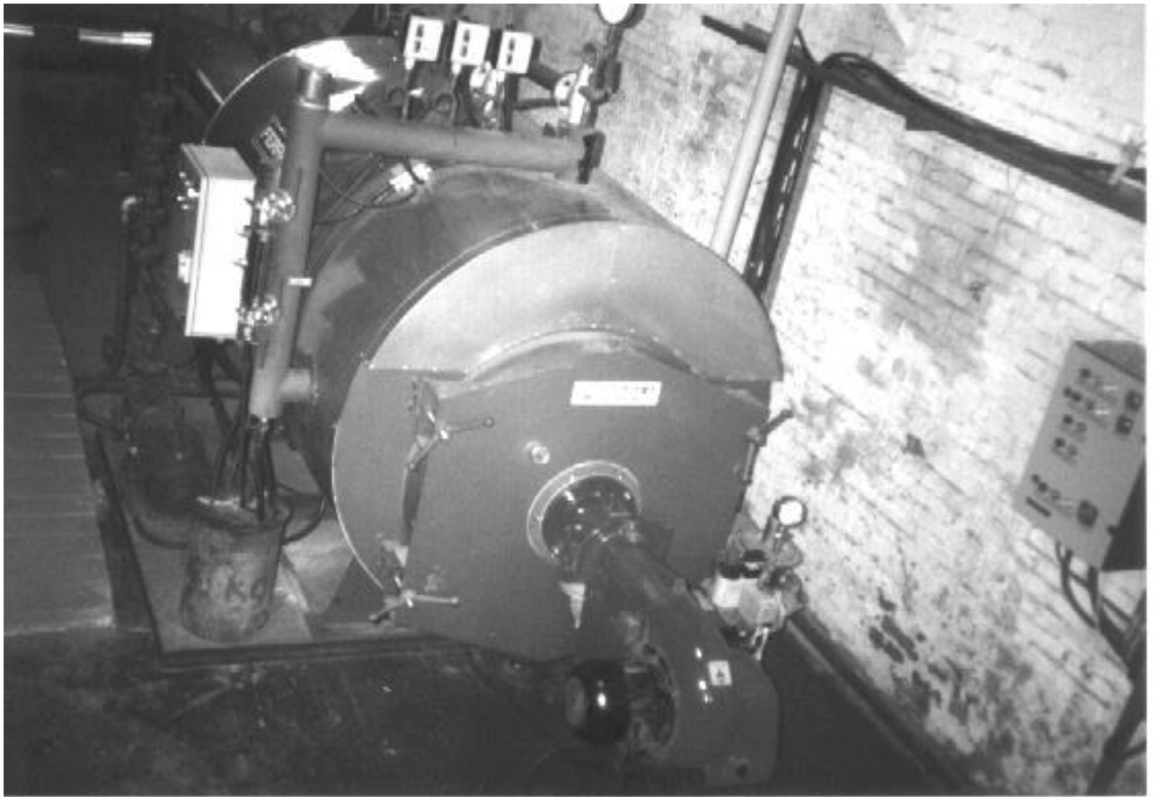
FOT.9. Kocioł parowy gazowy, wyd pary 1380 kg/h 6 bar – kocioł parowy prod. niemieckiej firmy FERROLI typu VAPOPREX 800 HP
