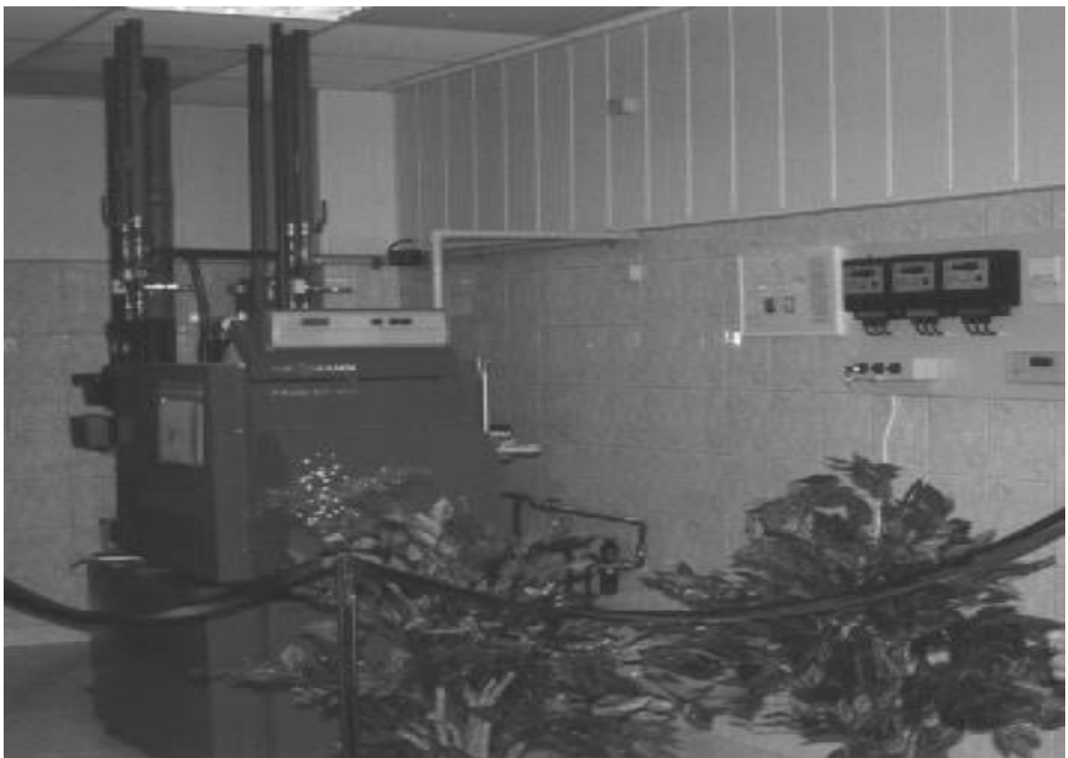
FOT.12. Kotłownia wodna gazowa. Kotły produkcji niemieckiej VISSMANN . ( Laboratorium Techniki Grzewczej AGH ).
