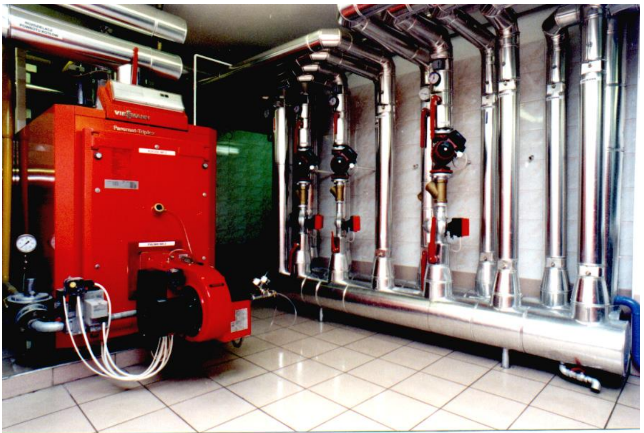
FOT.26,27. Kotłownie wodne co, cwu mocy 570 kW. (Hotel Europejski - Kraków).
