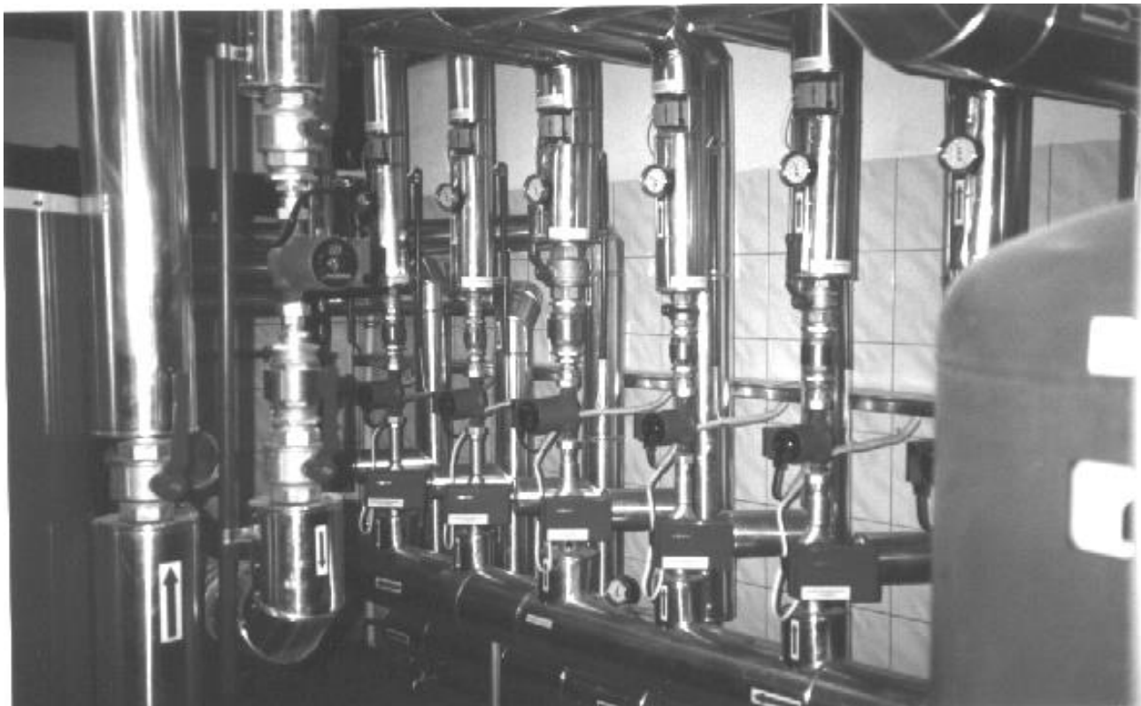
FOT.16. Kotłownia wodna gazowa, o mocy 340 kW. Kotły VISSMANN typu Paromat-Simplex strefy grzewcze (6). (Rabka – Budynek Główny, Szkoła Specjalna dla Dzieci Niewidomych)
