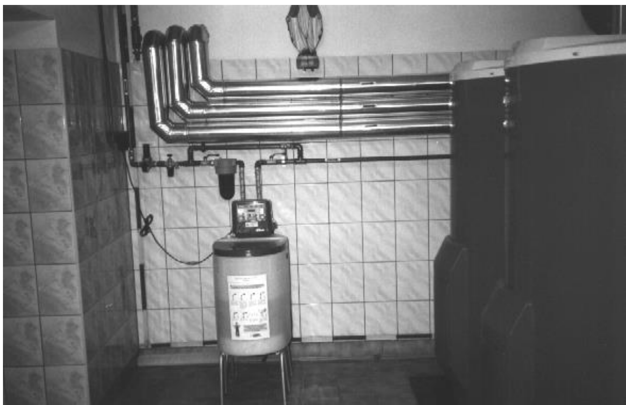
FOT.15. Kotłownia wodna gazowa o mocy 340 kW. Kotły VISSMANN typu Paromat-Simplex z podgrzewaczami pojemnościowymi VERTICELL . (Rabka – Budynek Główny, Szkoła Specjalna dla Dzieci Niewidomych)
